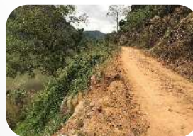
雨季に崩れた道路
